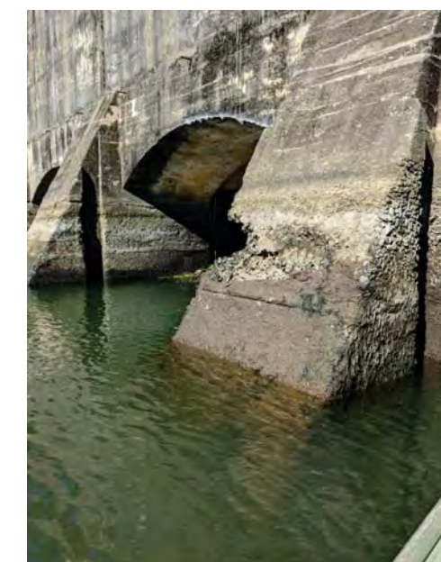
3 EXISTING BUTTRESS SPALL S402 SCALE: 1/8" = 1'-0"
